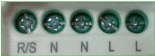
Bornas para la conexión del cableado.
